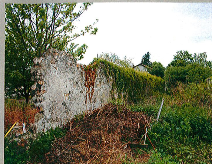
Mur avant restauration
