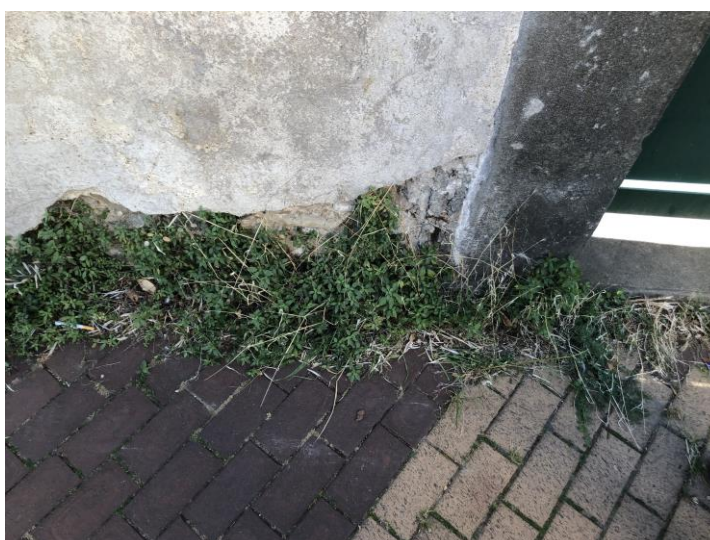
Soubassement dégradé côté rue
