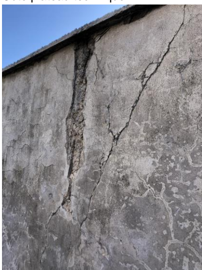
Epaufiture côté rue
