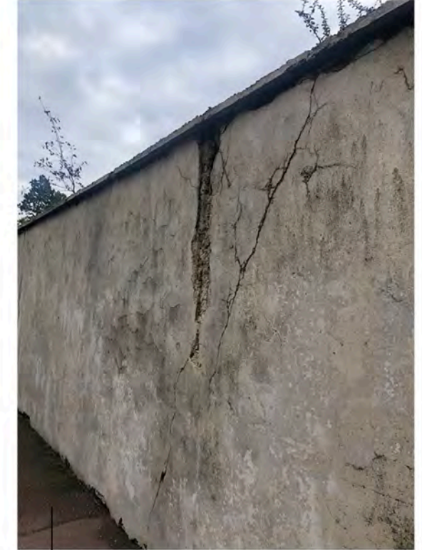
Mur à reprendre fissure
