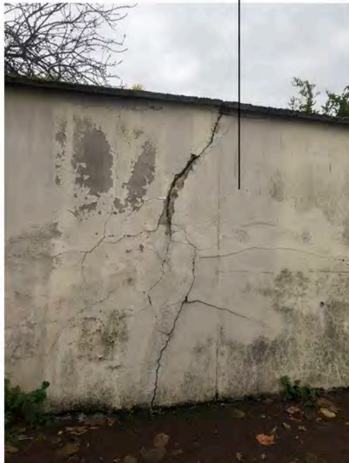
Mur à reprendre fissure
