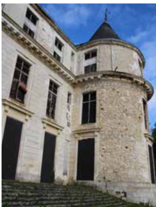
Fig.103. Les gargouilles de fortune du Château de Méréville (91) occasionnent la ruine des ouvrages en plâtre : la sous-face de la corniche et les enduits de la tour sont très dégradés. Source : Tiffanie Le Dantec.
