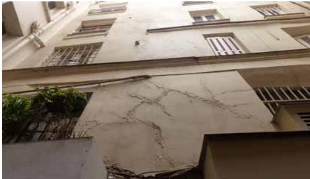
Fig.178. RPE fissuré et rebouché sur un enduit plâtre. Passage Saint-Foy, quartier du Sentier, Paris. Source : Tiffanie Le Dantec.
