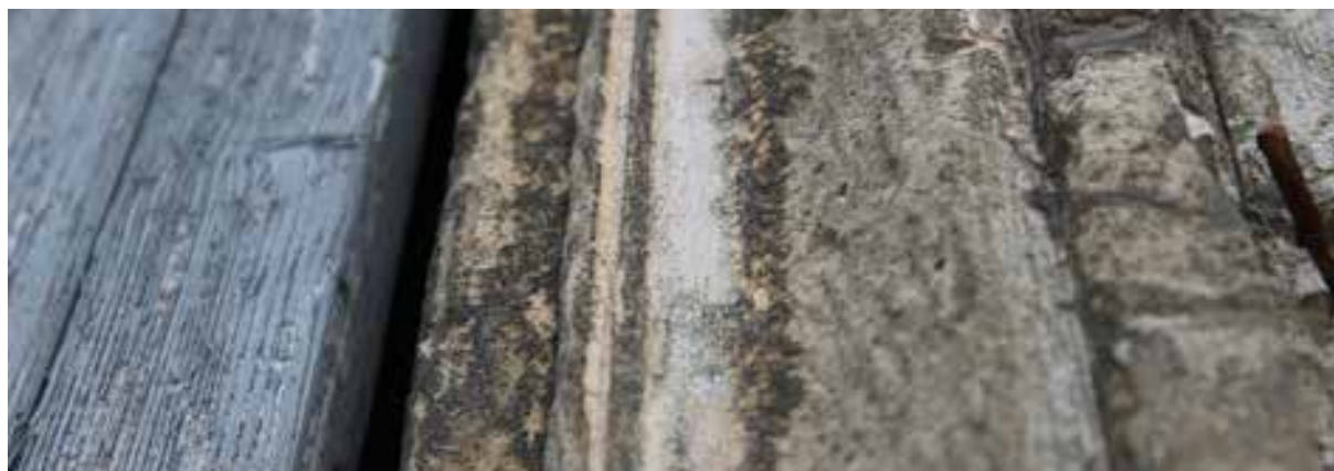
Fig.85. Restes de plusieurs couches de peintures dans une moulure abritée d'un encadrement de baie, Atelier Lorenzi, Arcueil (94). Source : Tiffanie Le Dantec.
