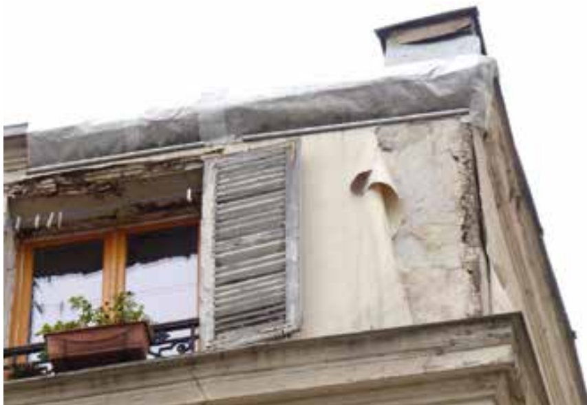
Fig.167. Peinture épaisse (RPE) qui se décolle suite à des infiltrations d'eau dans le mur. Rue Boutebrie à Paris. Source : Tiffanie Le Dantec.
