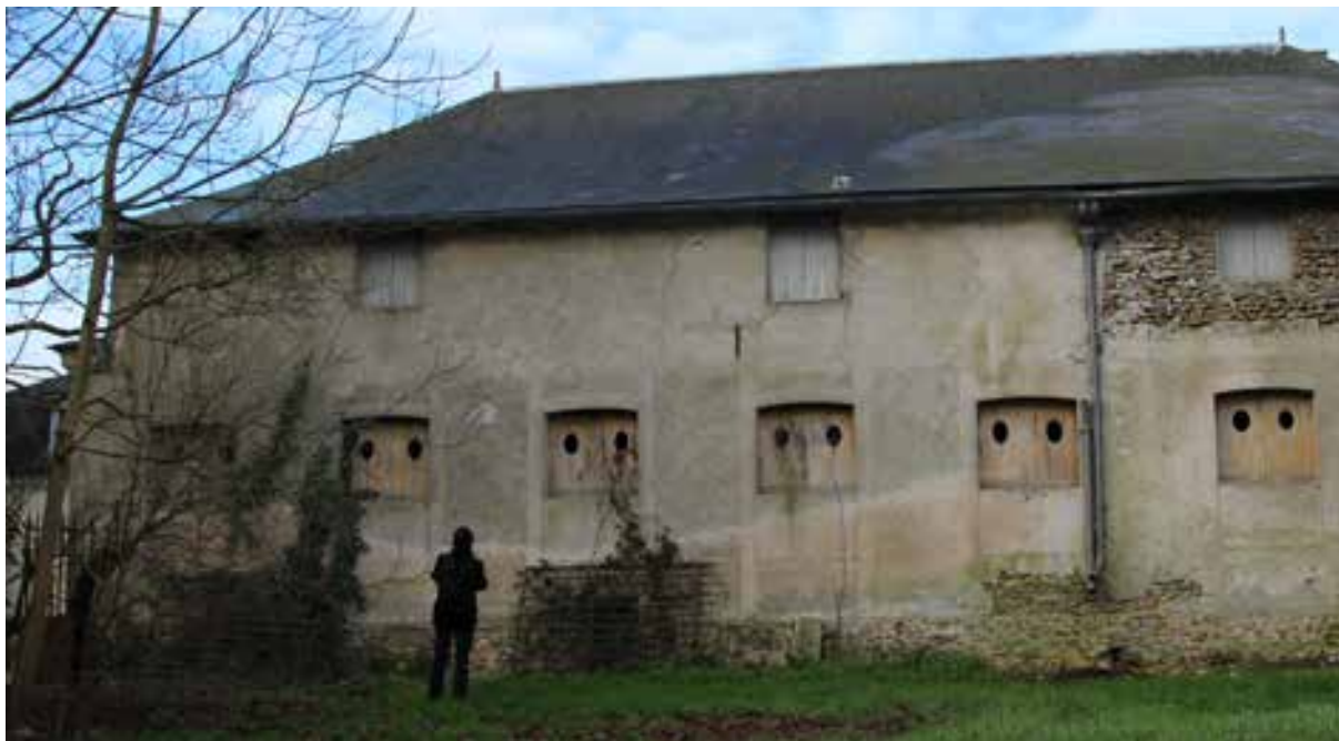
Fig.195. Façade de l'écurie du Château de Jossigny (77). La présence d'animaux et donc d'urine sur le long terme provoque des remontées de sels dans les murs et des enduits, qui sont visibles sur l'image sous la forme du balayage rosé et blanc en peid de mur. Source : Tiffanie Le Dantec.
