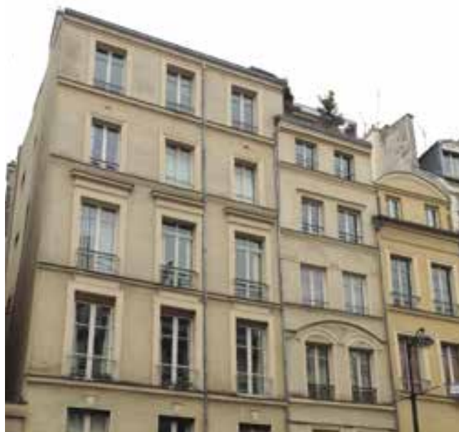
Fig.193. L'attique de cet immeuble rue Saint-Antoine (Paris) ravalé en MPC est soumis à des conditions climatiques plus rigoureuses et l'enduit a d'avantage souffert. Source : Tiffanie Le Dantec.
