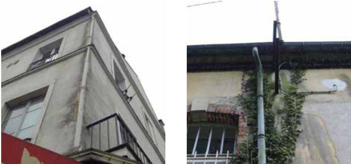
Fig.194. Descentes d'eaux pluviales encastrées ou accolées sur l'enduit. Elles sont des supports de ruissellement, qui est aggravé quand elles se bouchent. Source : Tiffanie Le Dantec.
