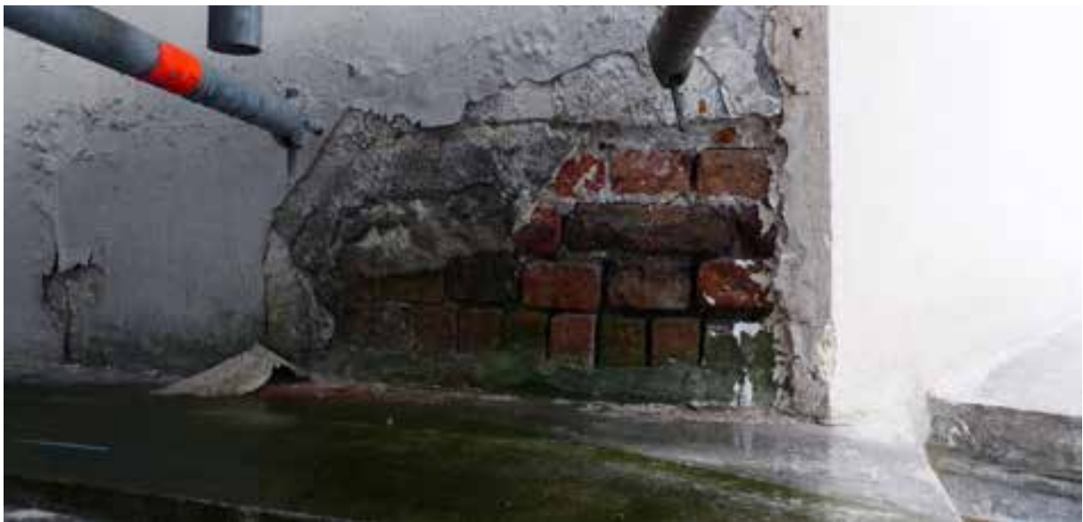
Fig.107. Le pied de l'attique du Théâtre de la Renaissance donne sur un large débord propice garder l'eau. Cette humidité stagnante a finalement rongé le pied de mur, l'enduit et infiltré la maçonnerie de briques. Source : Tiffanie Le Dantec.
