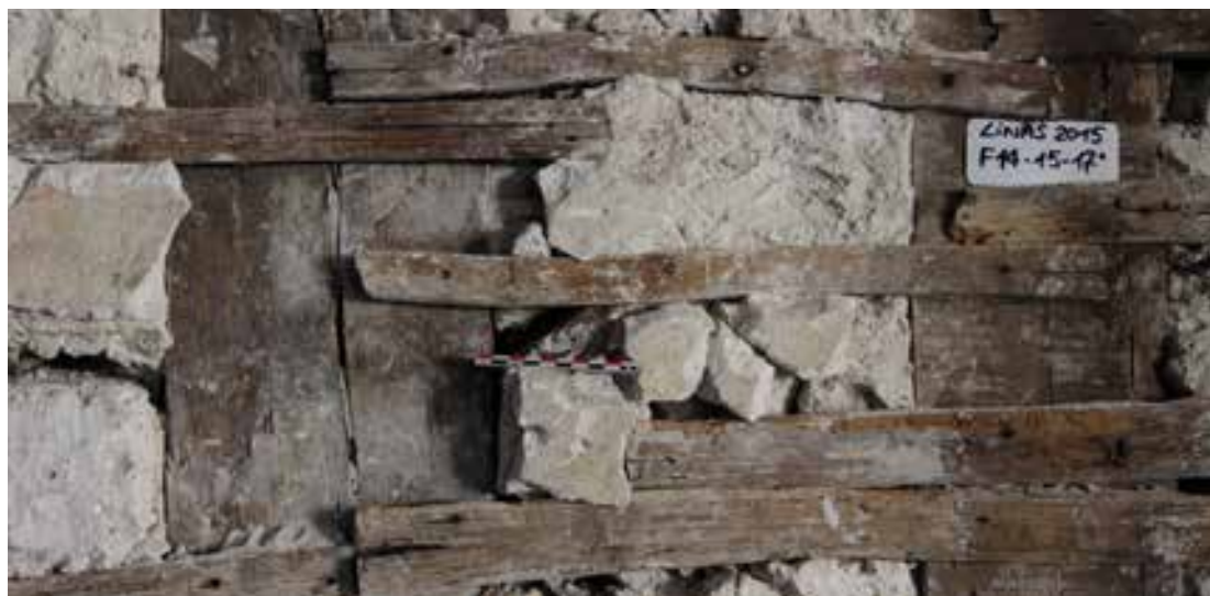
Fig.90. Une cloison en pans de bois hourdés de plâtras recouverts d'un lattis de bois sur lequel était mis en oeuvre un enduit de plâtre aujourd'hui lacunaire. Maison de la fin du XVI e siècle, Linas (91) (MLI). Source : Tiffanie Le Dantec.
