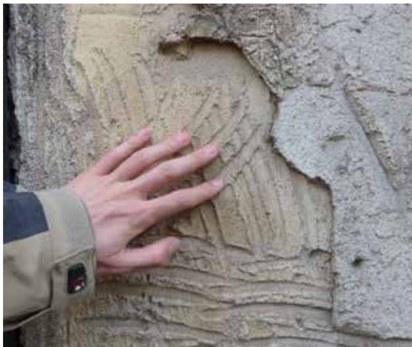
Fig.48. Le décollement de la couche de finition permet de voir le traitement de surface du crépi de cette maison de Goussainville (95). Il a été strié avec les doigts pour assurer l'accroche de la dernière passe. Source : Tiffanie Le Dantec.
