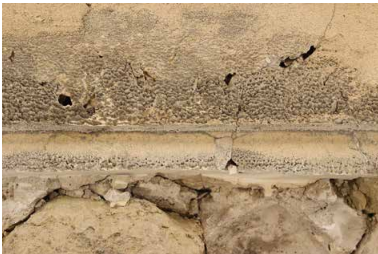
Fig.191. Le clocher de l'église de Bouqueval (95) est dissout sur les façades les plus exposées aux vents dominants (ouest et sud-ouest), ce qui fait mentir les graphiques précédents. Le clocher n'est ni masqué ni protégé. Source : Tiffanie Le Dantec.
